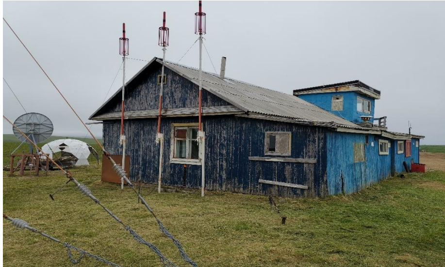
Фото 11. Здание аэровокзала, признанное аварийным
