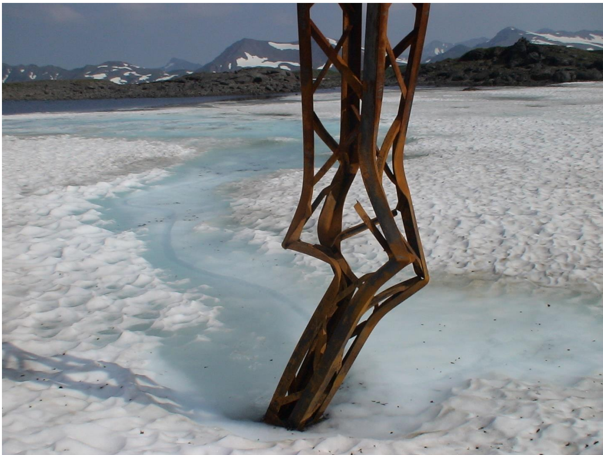
Фото № 1. Вытаявшая опора ЛЭП, повреждённая снеговой нагрузкой на плато вулкана Горелый (август 2006 года)
