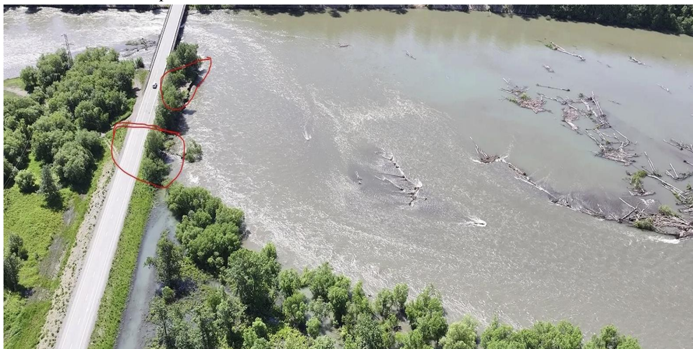
Рис. 2 – Эрозия откосов, прилегающих к дорожному полотну
