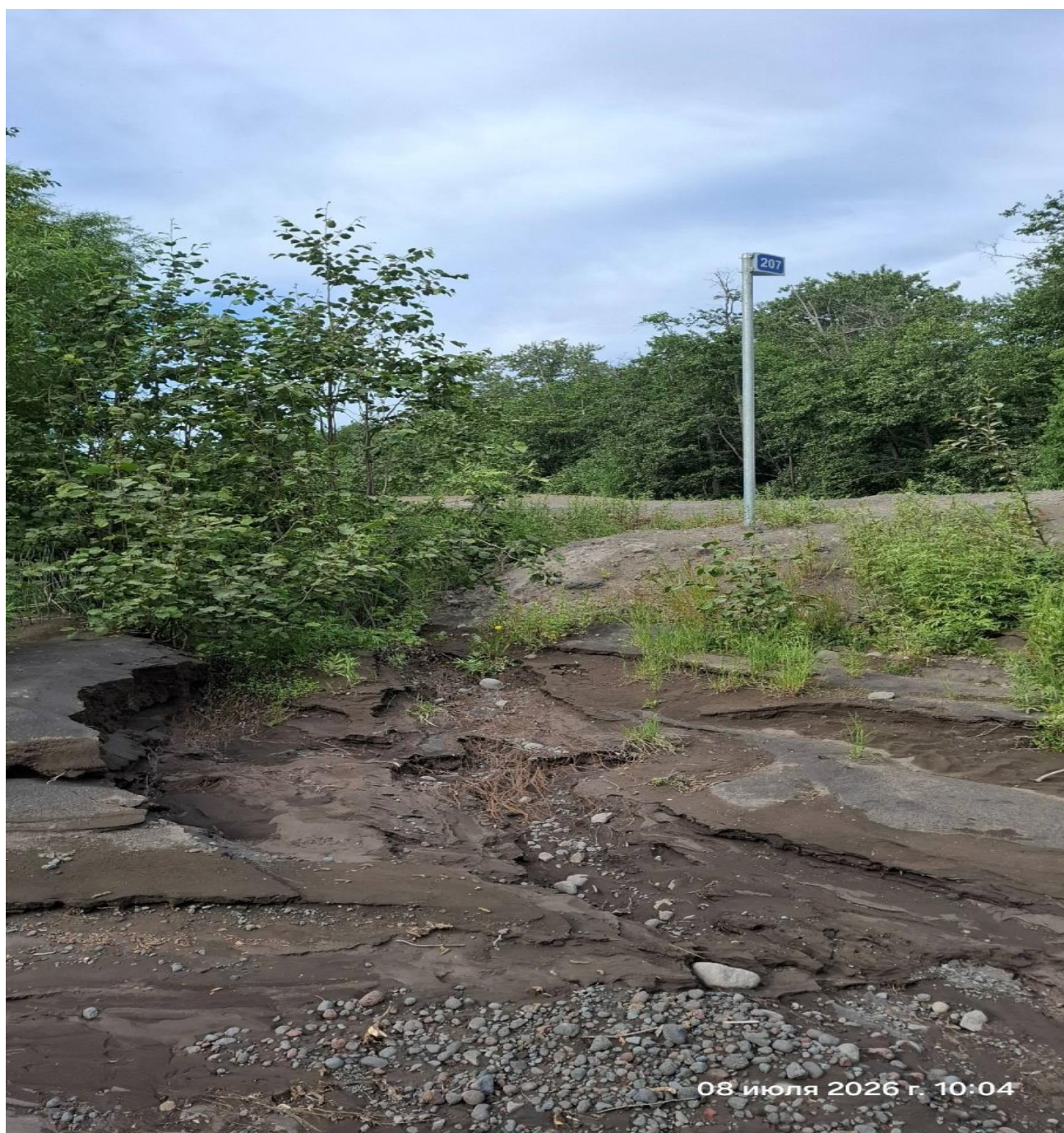
Фото 1. Последствия от воздействия водного потока «сухой реки» на откос дороги
